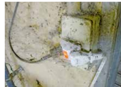
写真2 外れかかったプラグ
