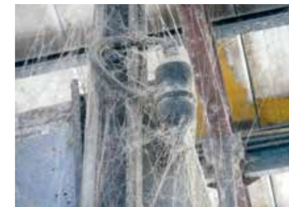
写真3 目につきにくい位置にある蜘蛛の巣が張った配線
